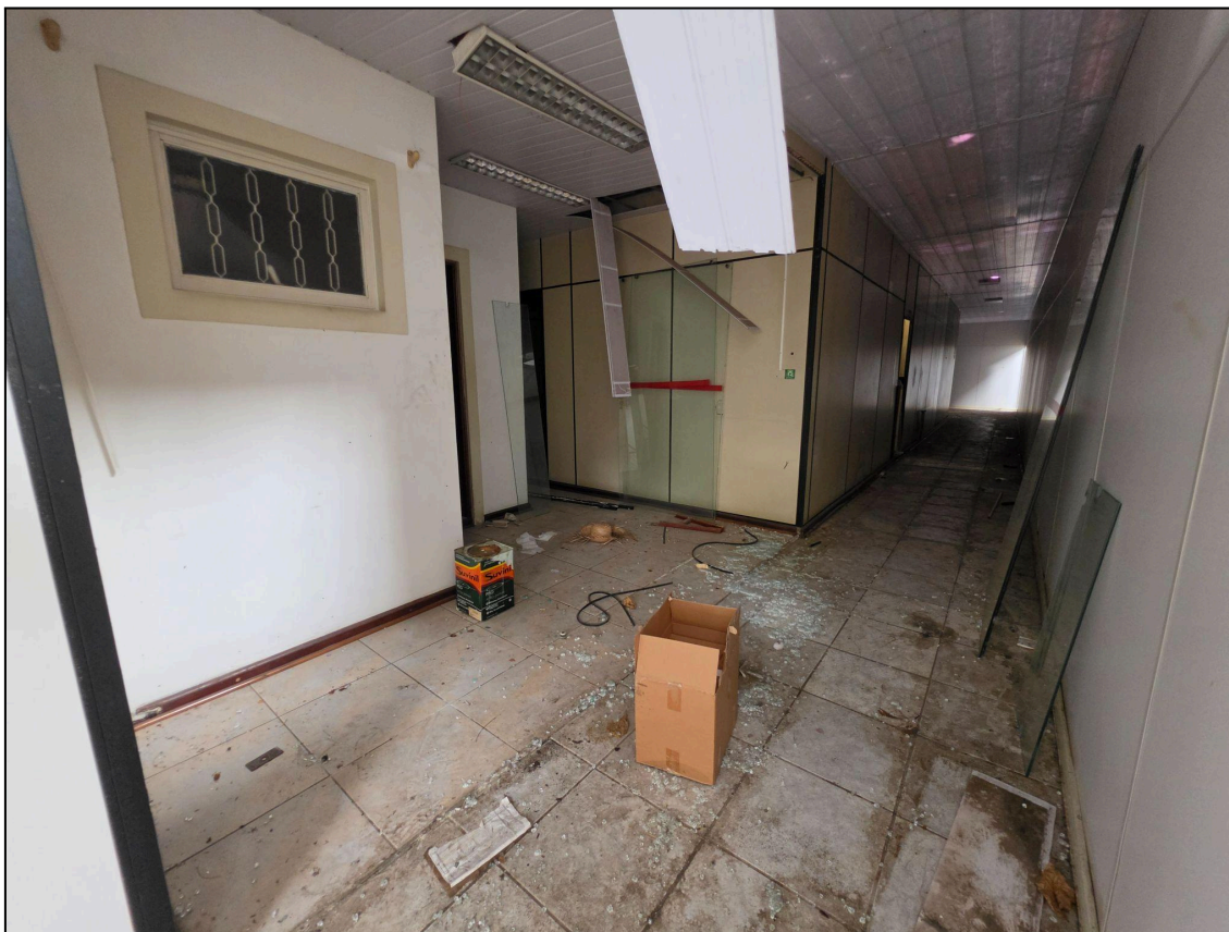
Imagem 12: Ambiente interno com vidros quebrados.
