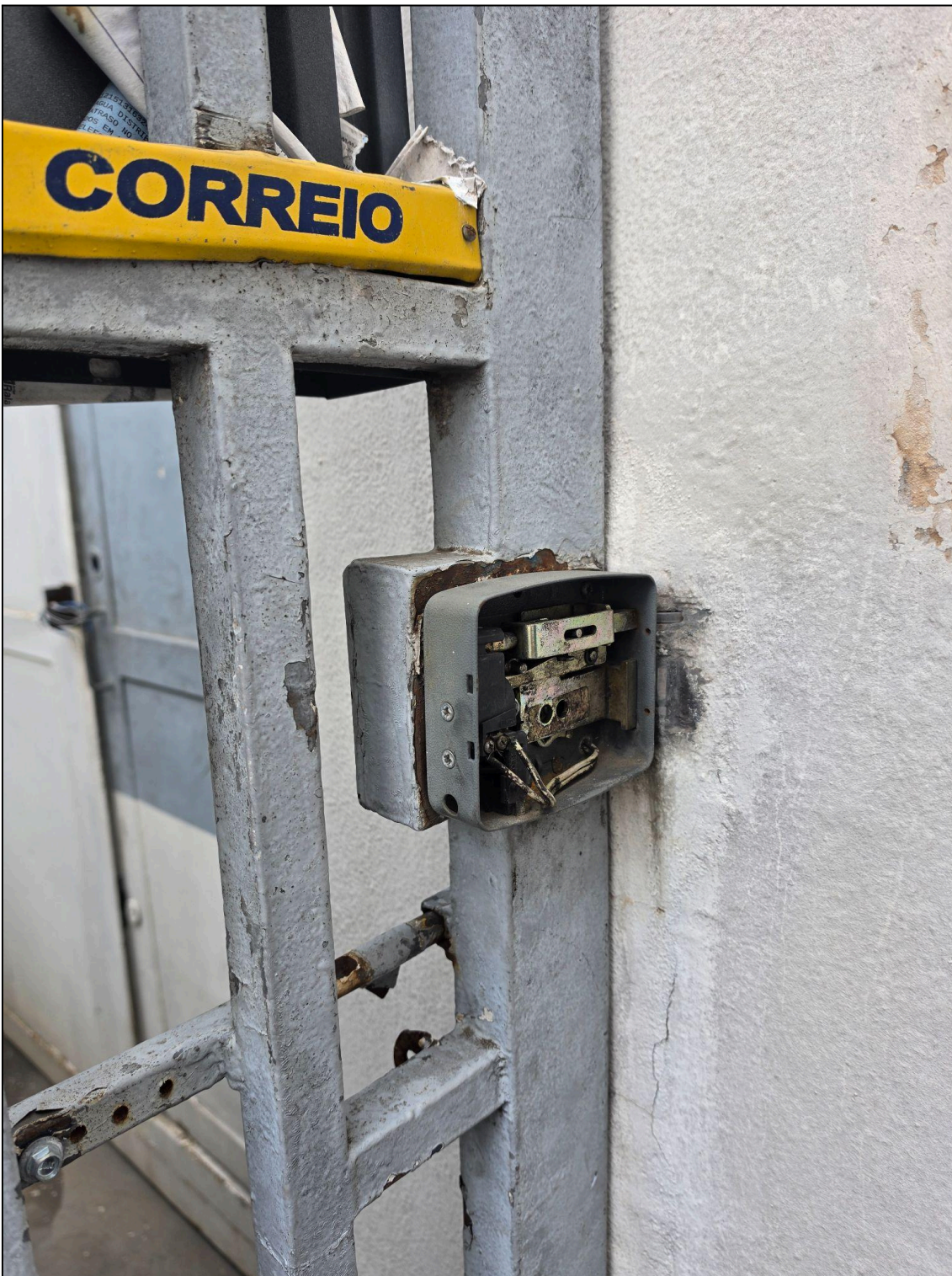
Imagem 1: Fechadura lateral danificada.
