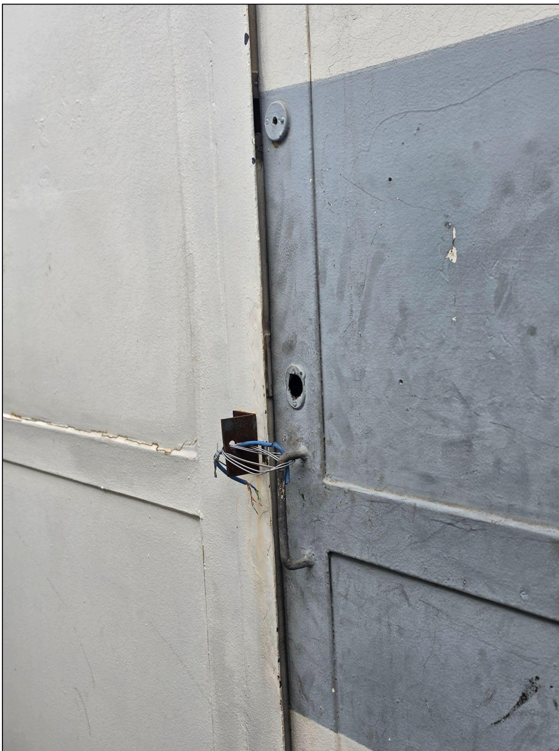
Imagem 2: Fechadura do segundo acesso danificada.
