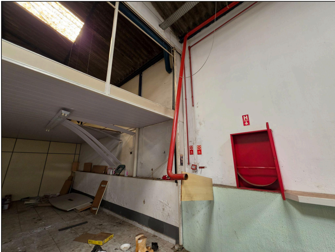
Imagem 6: Sistema de combate a incêndio/hidrante furtado.
