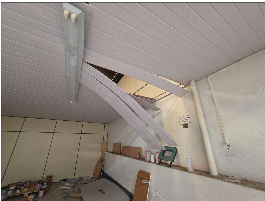
Imagem 7: Placas do forro danificadas.
