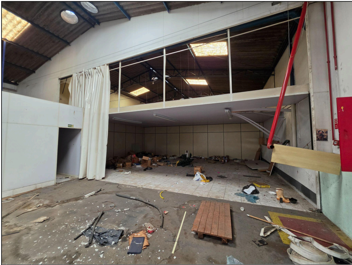
Imagem 5: Fundos do galpão com itens despejados no piso.
