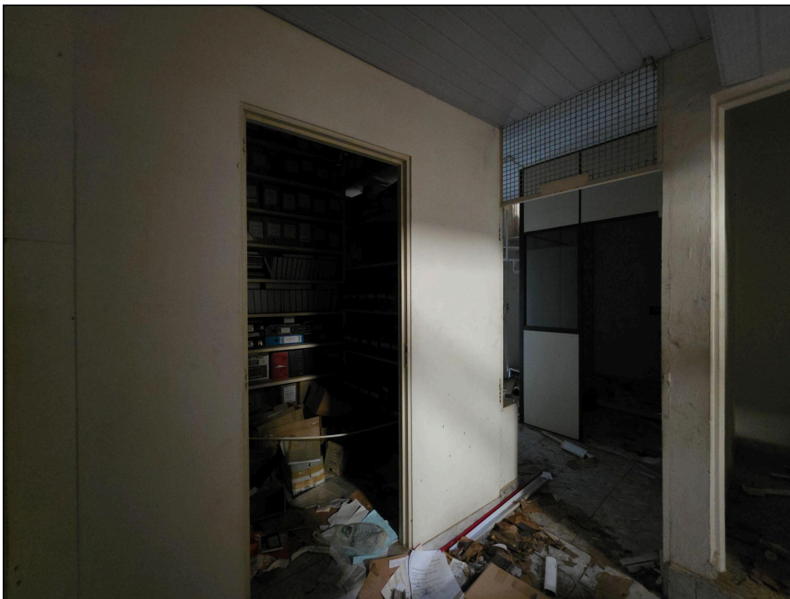
Imagem 19: Área de arquivos vandalizada.
