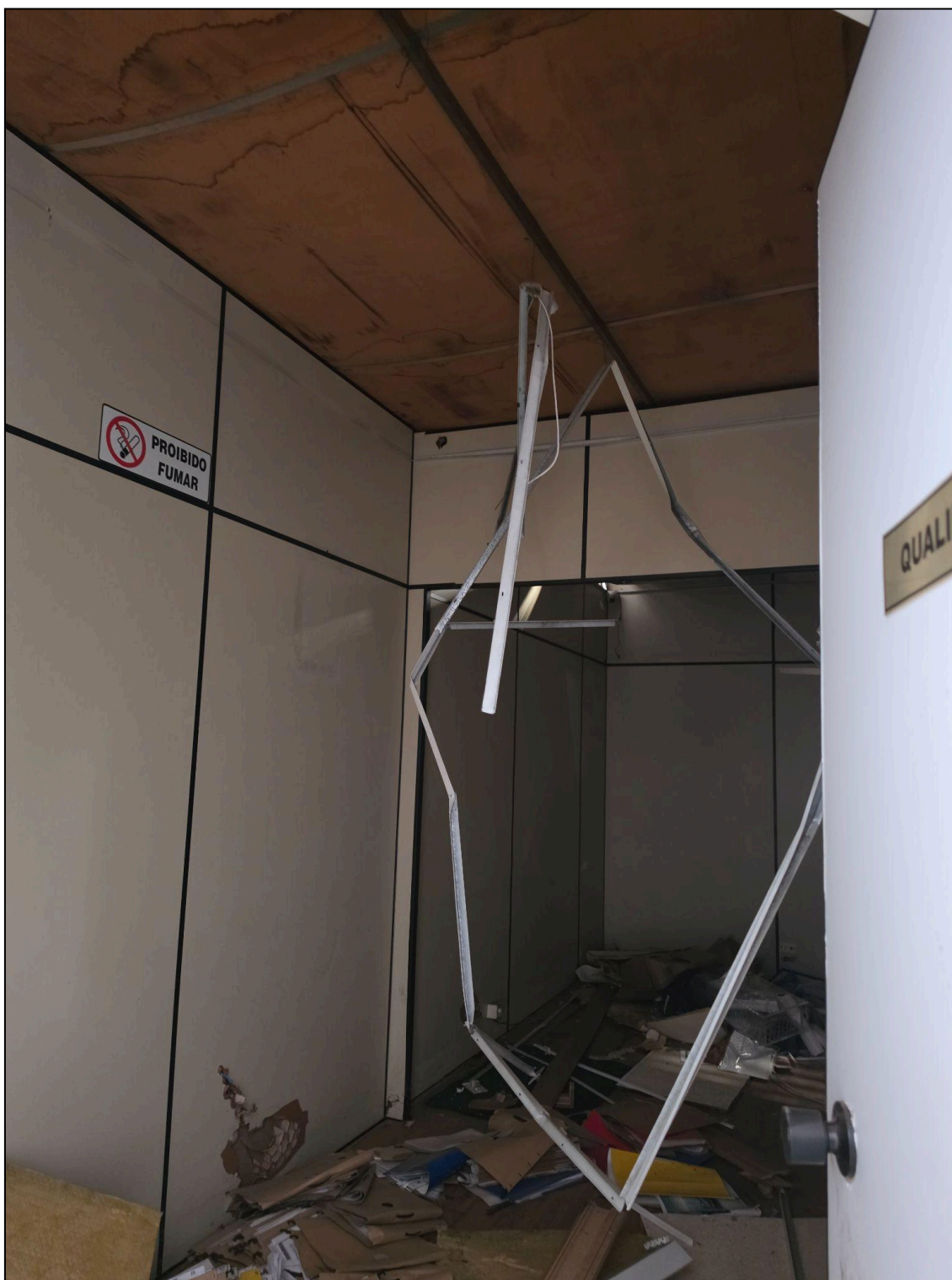
Imagem 15: Sala sem o fechamento do teto e depredado.
