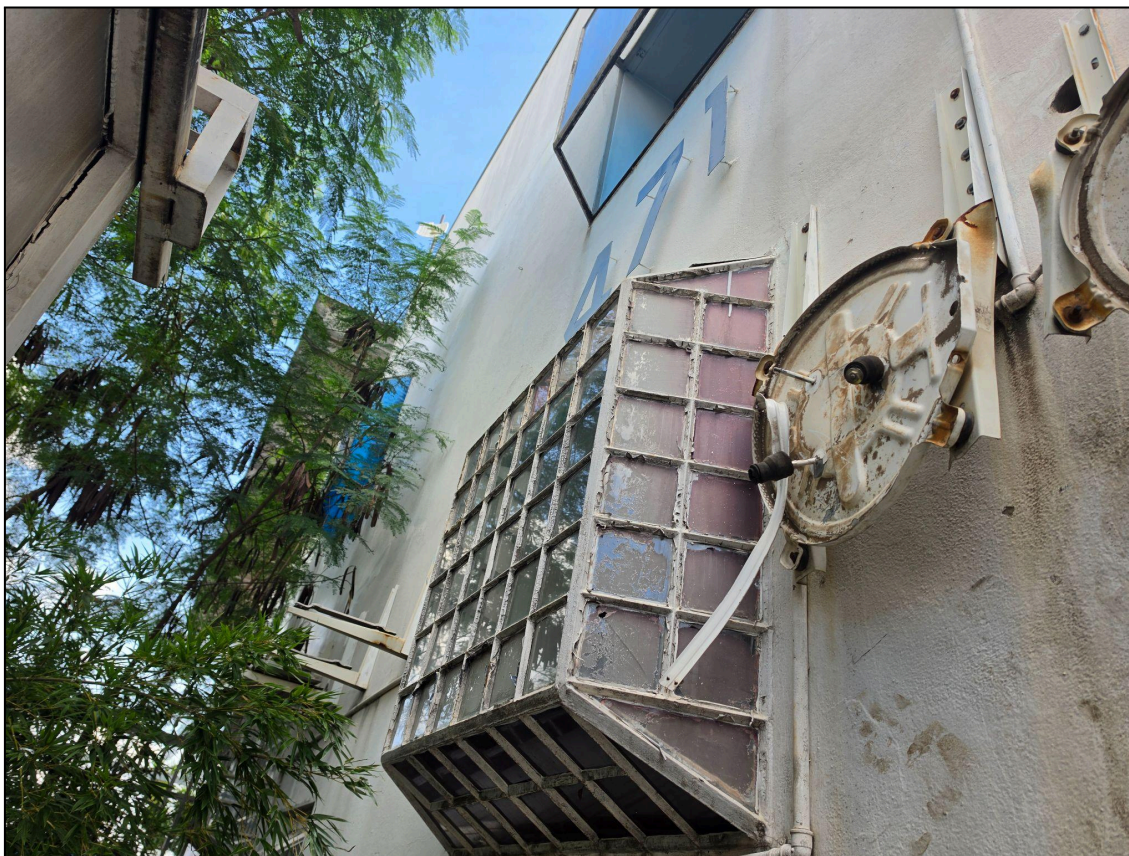
Imagem 17: Furto da condensadora.
