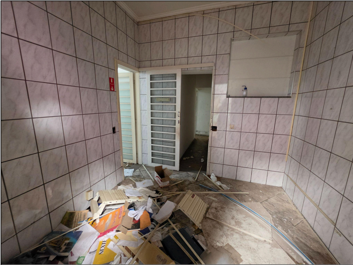
Imagem 11: Ambiente interno vandalizado.
