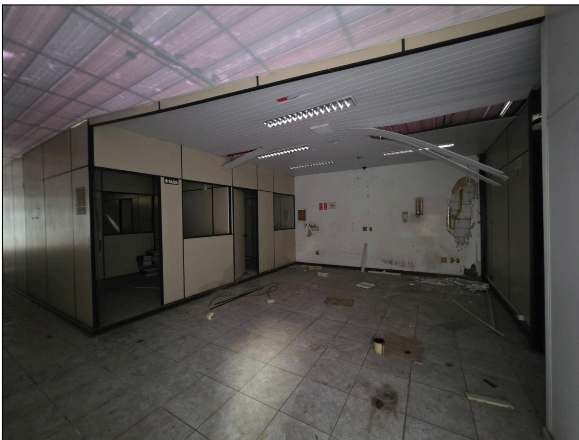
Imagem 16: Sala sem o fechamento do teto e danificado.
