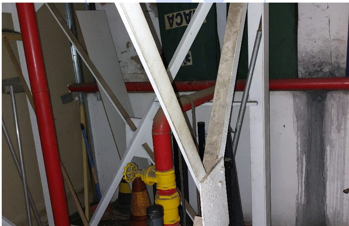
tubulação do sistema de incêndio
