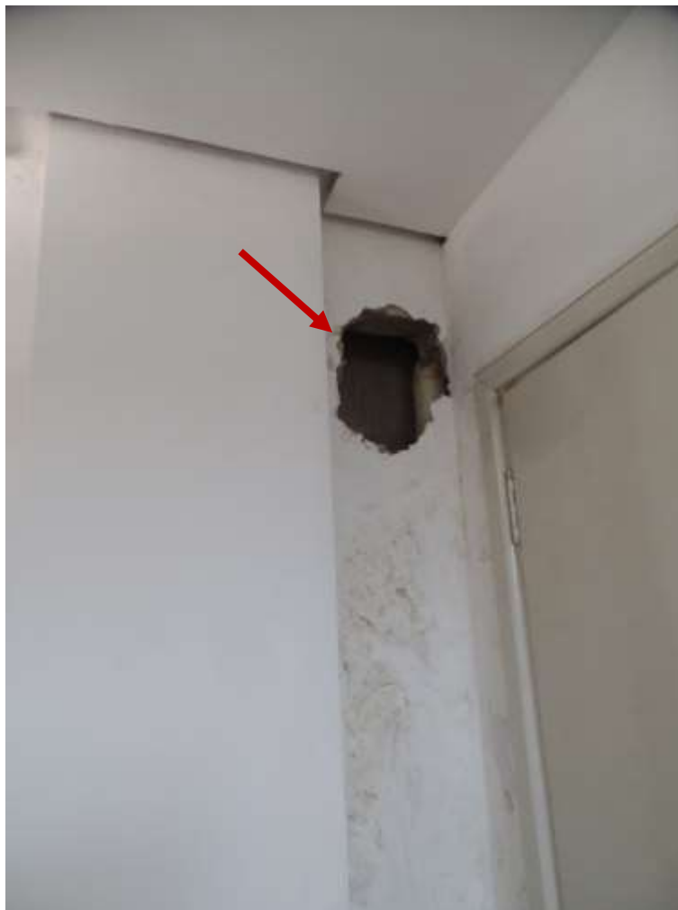
FOTO N.º 55- Vista da abertura do forro de gesso na boneca ao lado da porta.
