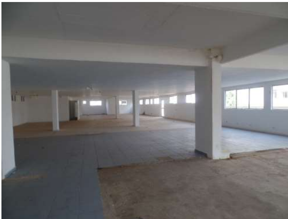
FOTO N.º 56- Tomada interna da sala comercial, faltando acabamento.
