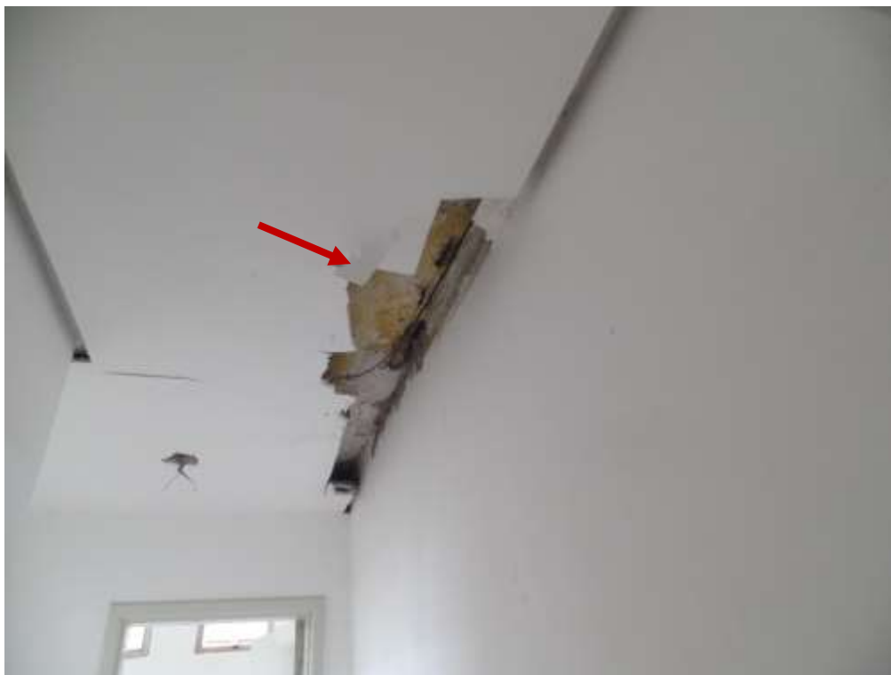
FOTO N.º 54- Detalhe do teto da sala comercial desabamento parcial do forro de gesso.
