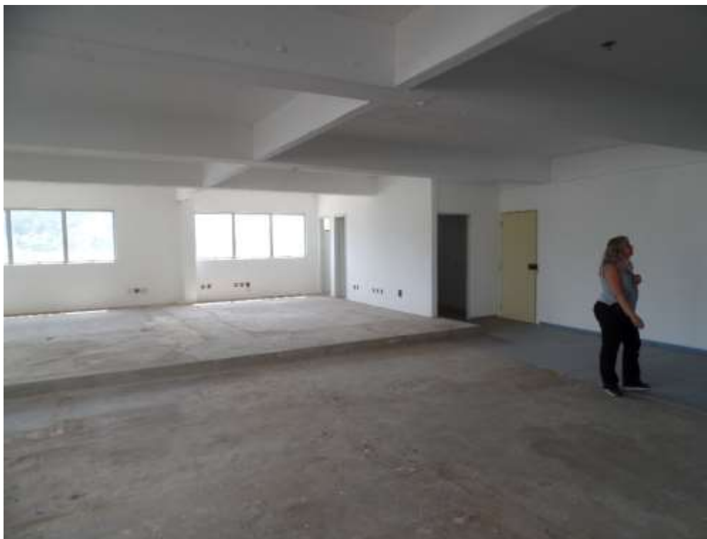
FOTO N.º 49- Aspecto interno da sala comercial faltando acabamento.
