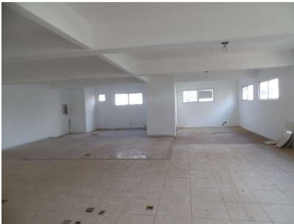
FOTO N.º 58- Detalhe interno da sala comercial, faltando acabamento.
