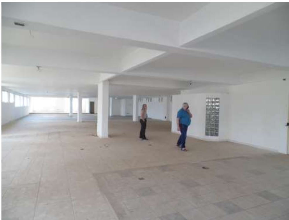
FOTO N.º 61- Aspecto interno da sala comercial, faltando acabamento.
