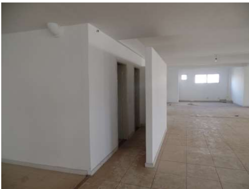
FOTO N.º 62- Detalhe interna da sala comercial, faltando acabamento.
