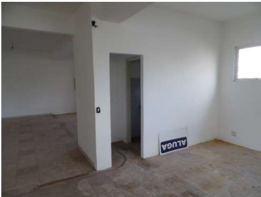
FOTO N.º 59- Vista interna da sala comercial, faltando acabamento.
