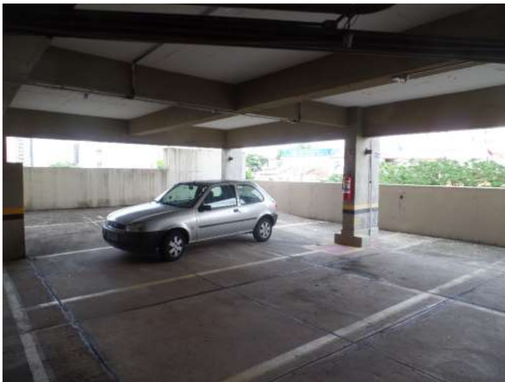
FOTO N.º 25- Tomada interna dos boxes de garagens no pavimento intermediário.
