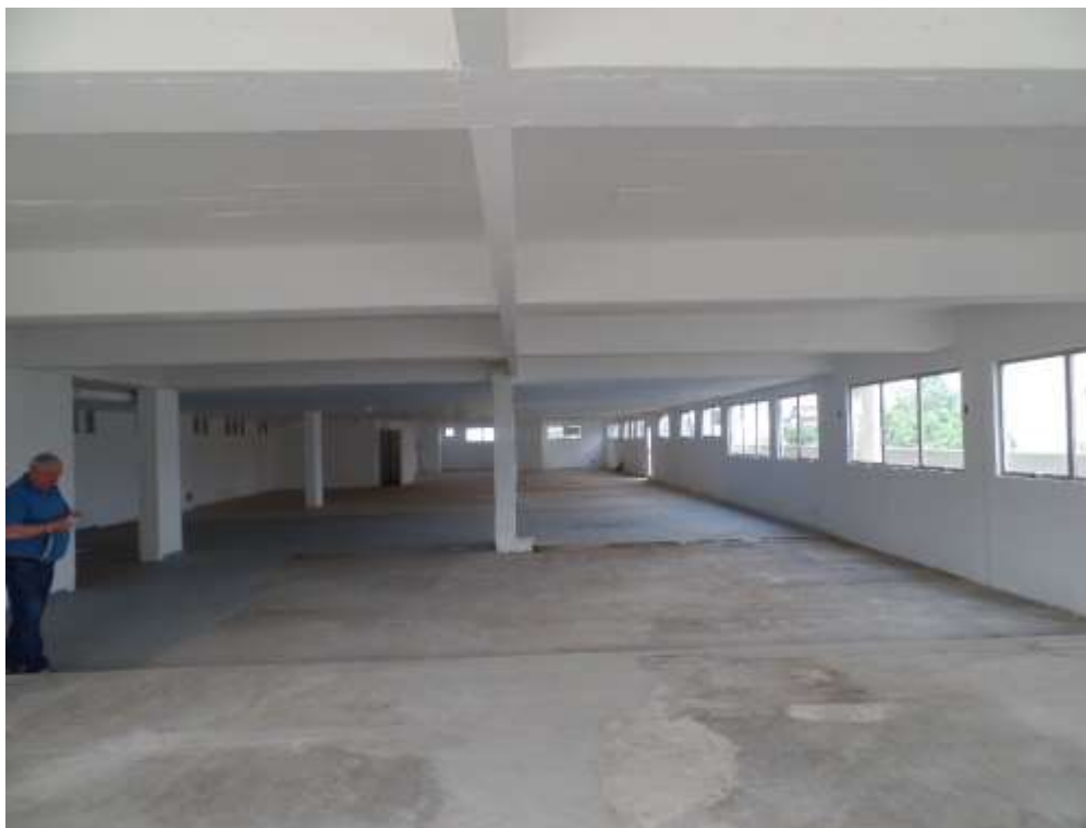
FOTO N.º 45- Aspecto interno da sala comercial, faltando acabamento.
