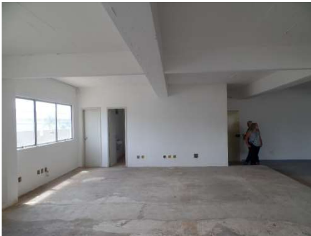
FOTO N.º 46- Detalhe interno da sala comercial, faltando acabamento.
