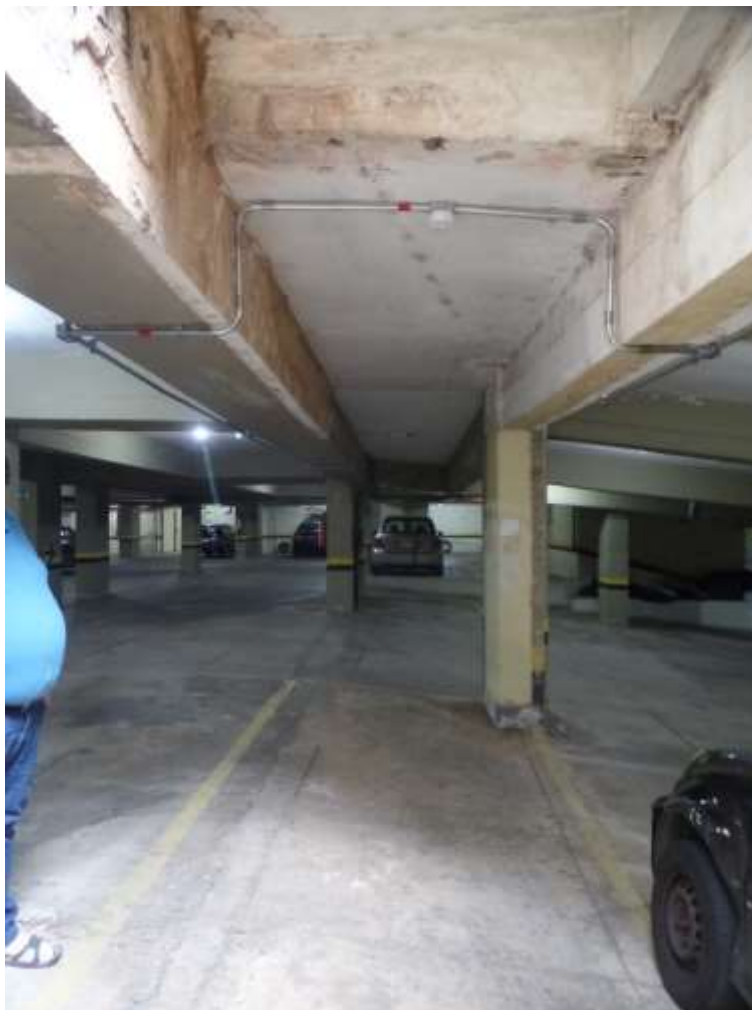
FOTO N.º 11- Tomada interna do box de garagem de n.º 54.
