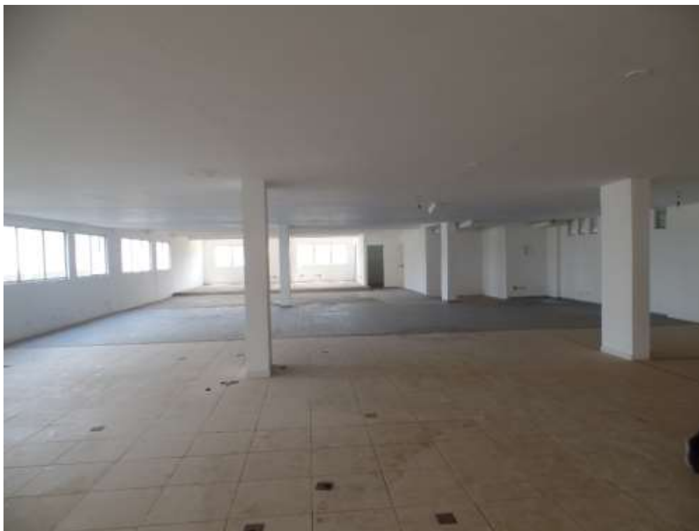
FOTO N.º 57- Aspecto interno da sala comercial, faltando acabamento.
