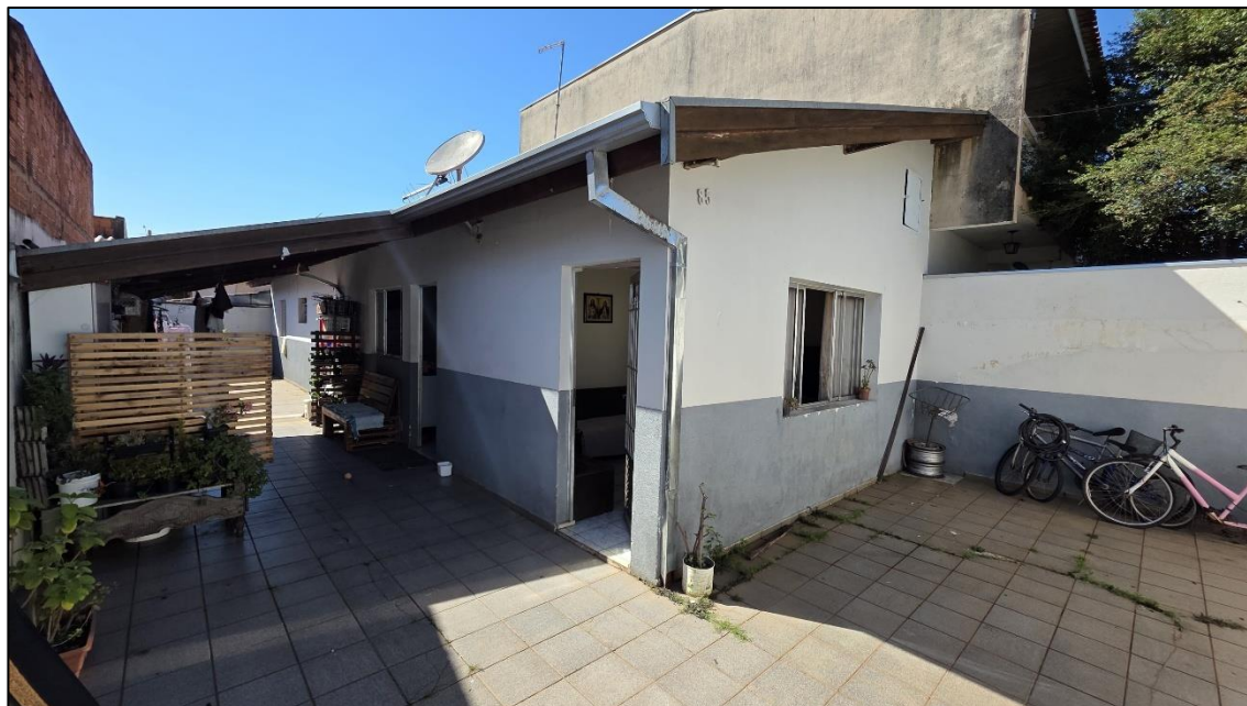
Imagem 09: Vista para a edificação e corredor lateral, com piso cerâmico (com trincas), paredes com reboco e pintura e cobertura de telha cerâmica.
