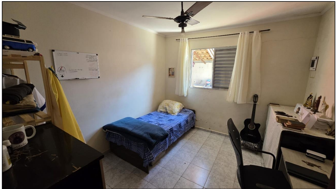
Imagem 15: Quarto 01 com piso cerâmico, paredes e laje rebocados com pintura e moldura de gesso. Presença de umidade ascendente nos rodapés.
