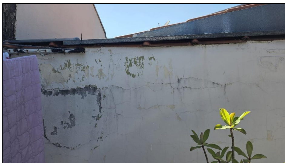
Imagem 25: Patologias encontradas no imóvel: marcas de umidade ascendente nos rodapés, marcas de infiltração e desprendimento da pintura e trincas.
