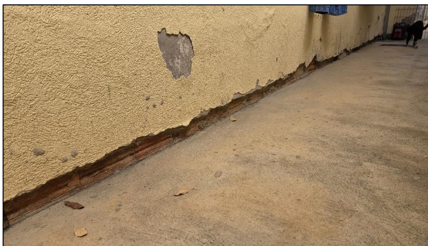
Imagem 58: Patologias encontradas no imóvel: trincas nos cômodos e presença de umidade nos rodapés das paredes.
