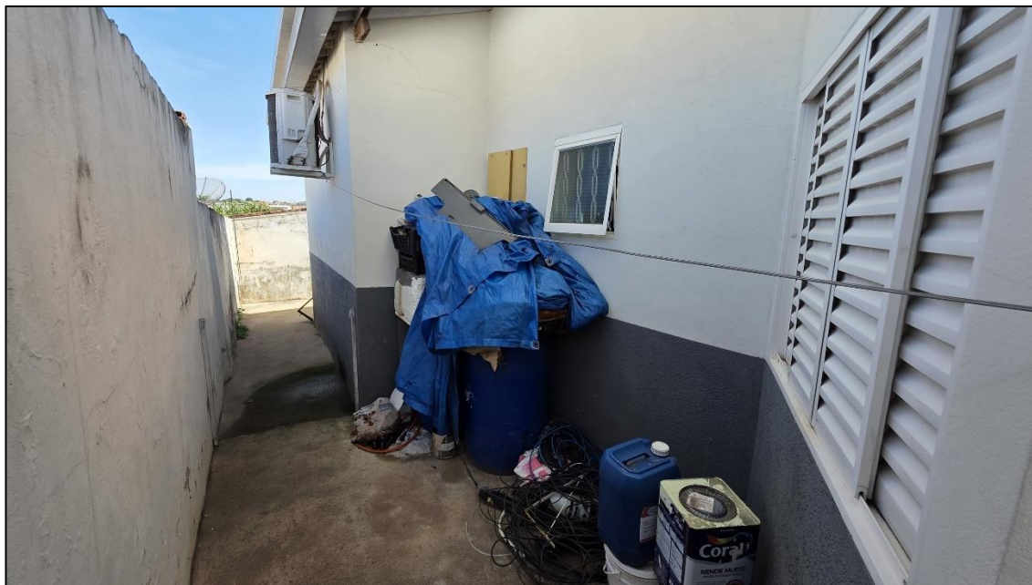
Imagem 38: Fundos do imóvel. Corredor lateral externo somente no contrapiso. Presença de umidade e desgaste da pintura.
