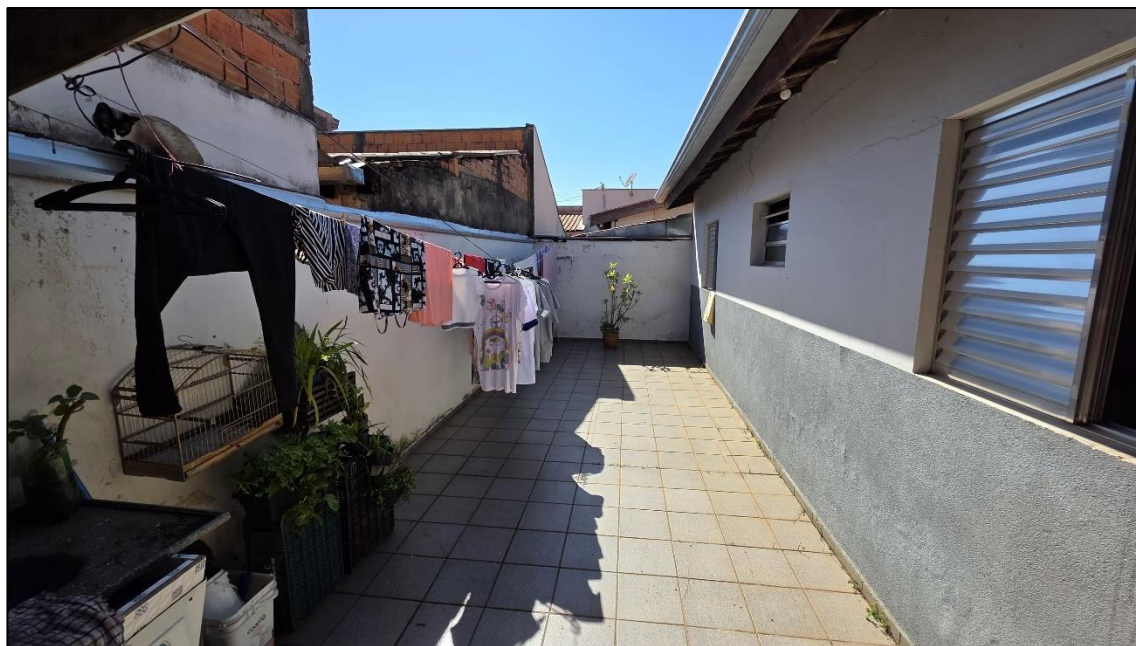
Imagem 22: Lateral do imóvel com vista para os fundos, contendo piso cerâmico, paredes com reboco e pintura sem cobertura. Trincas nas paredes dos quartos.
