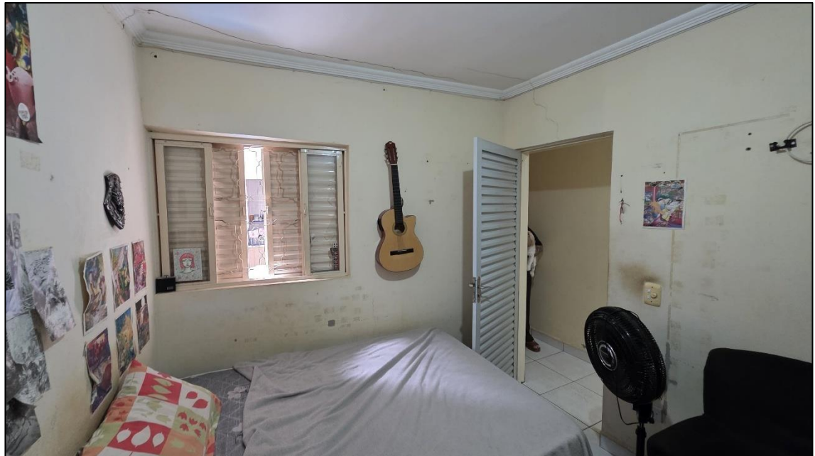
Imagem 51: Quarto 01. Presença de rachadura no teto.
